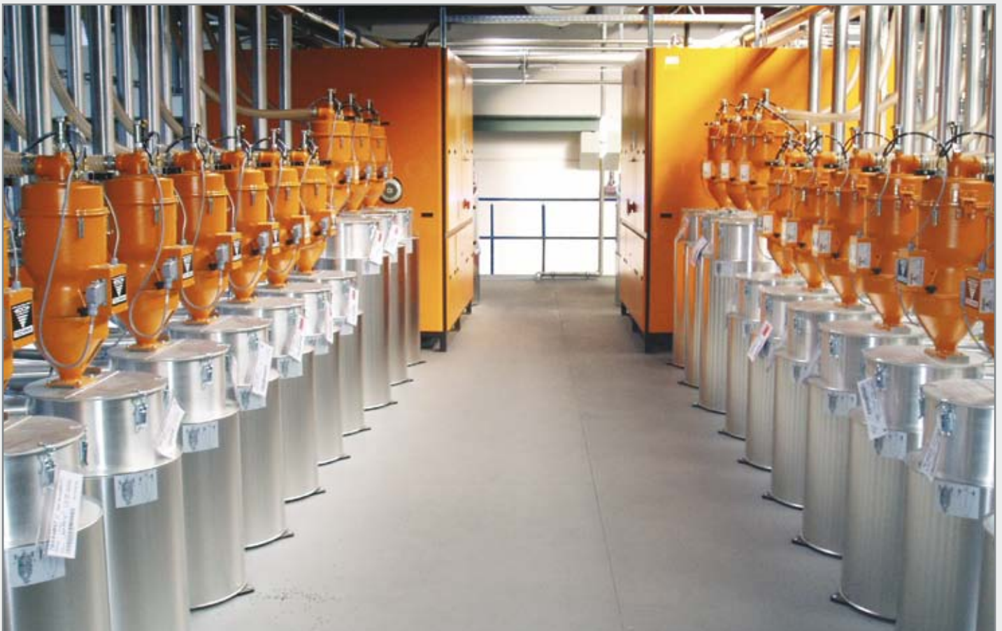
Zwei Trockenlufttrockner CKT 1000 installiert bei einem Automobilzulieferer
