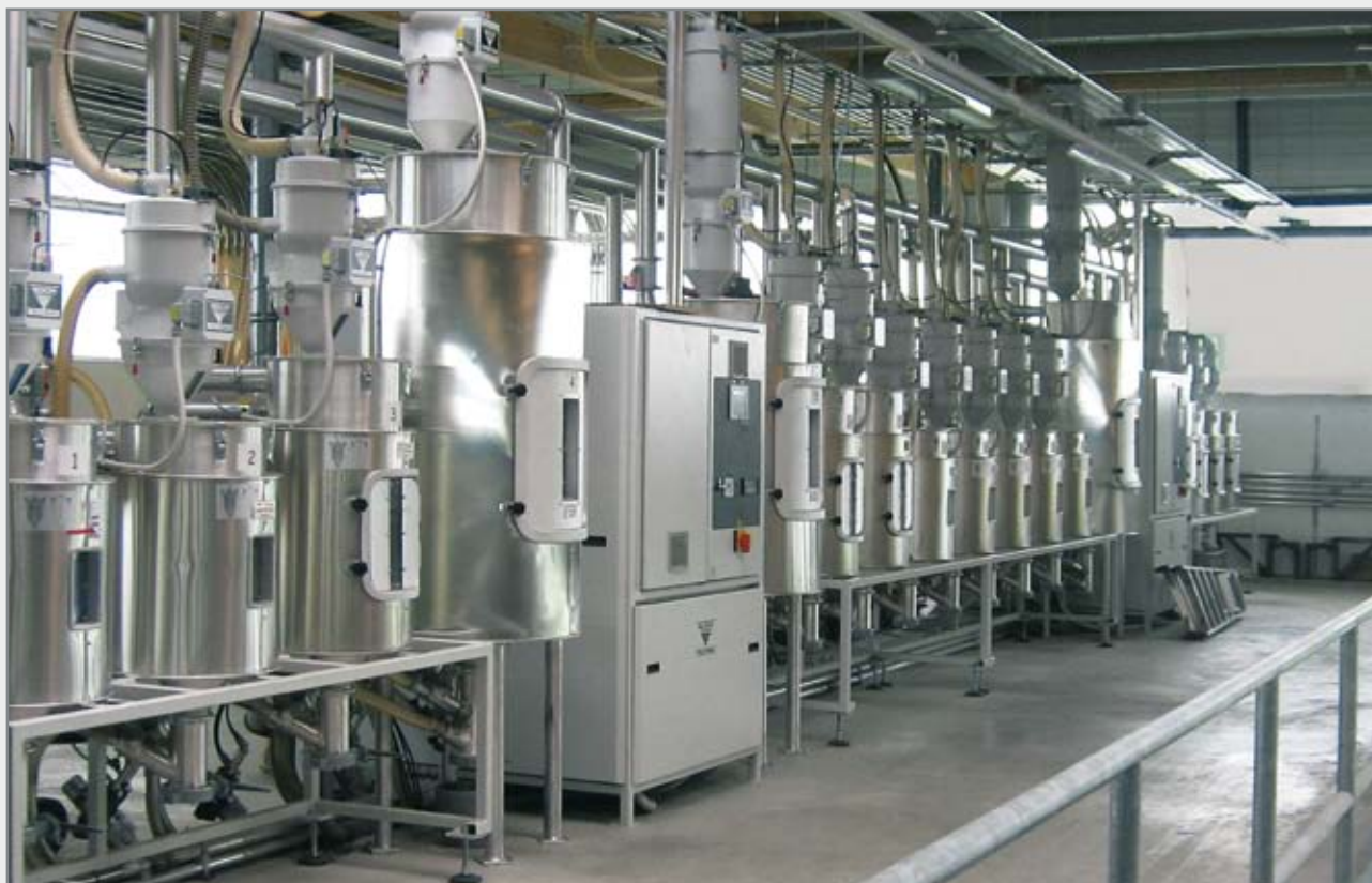
Zentrale Trocknungsanlage bestehend aus mehreren CKT-Trocknern zur Versorgung der Produktion eines international bekannten Spielwarenherstellers
