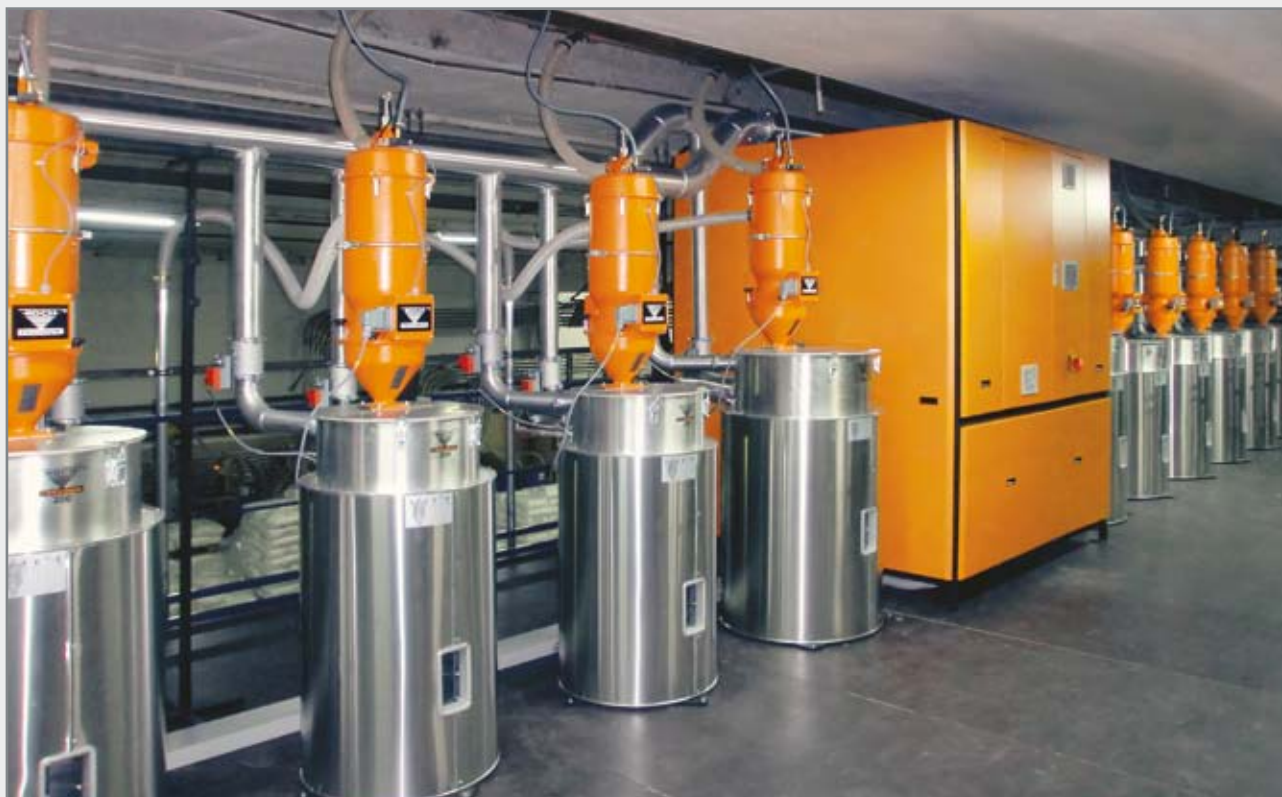
Trockenlufttrockner CKT 1000 mit Trocknungsbehälter von je 200 Liter, integriert in die zentrale Granulatversorgung eines Spielwarenherstellers
